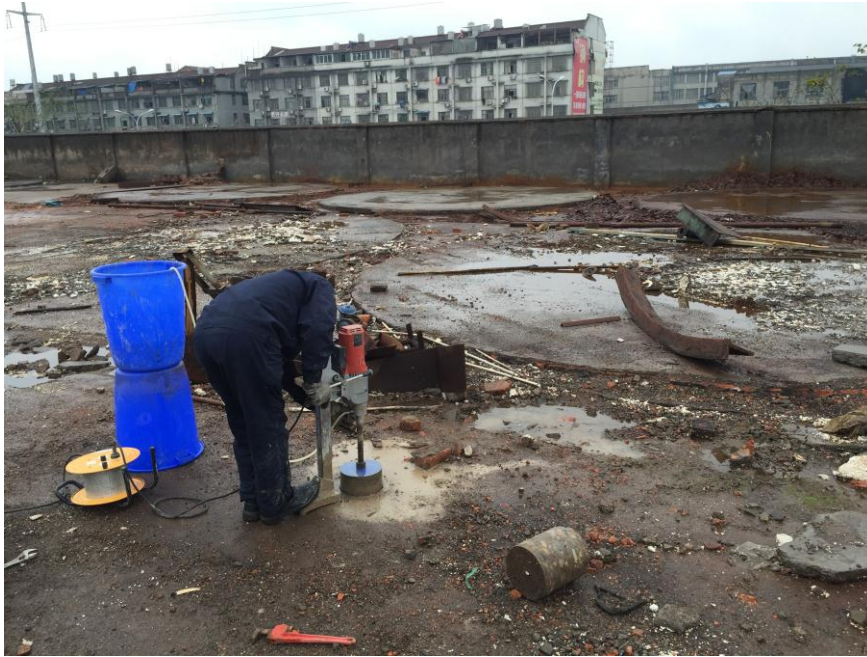
3. 原氯仿储罐区
